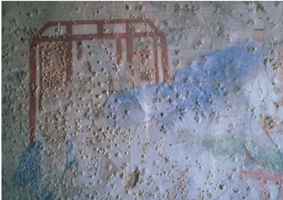
写真2. 食塩による194窟の壁画の剥落
